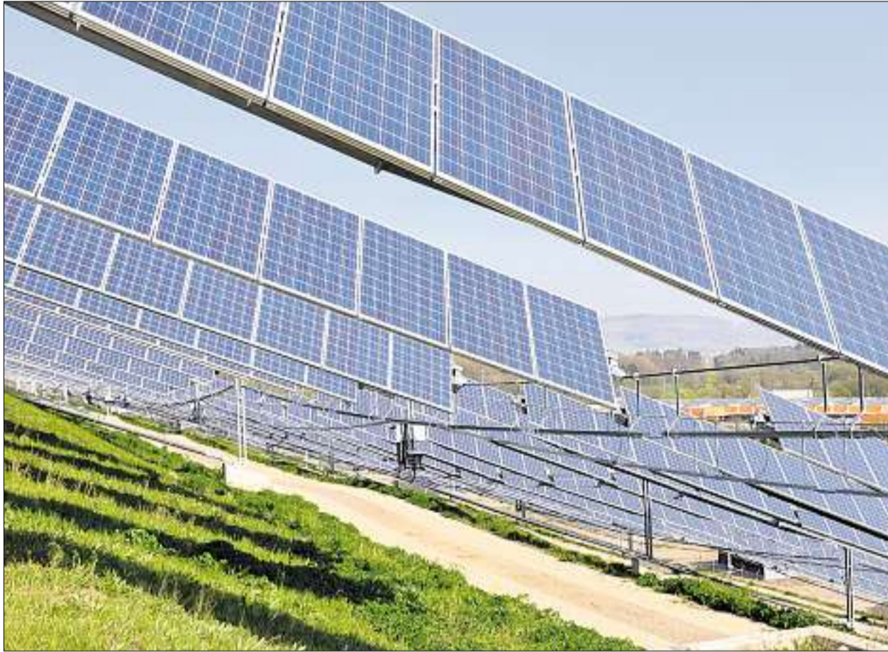
Die Moduloberfläche der 7600 Quadratmeter grossen Solaranlage in Hochrhein beträgt 4781 Quadratmeter. (maw)
